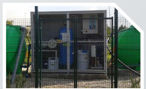
SYSTEMES DE TRAITEMENT TERTIAIRE
